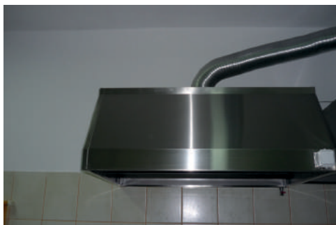
Okap przyścienny nad kuchnią gazową
